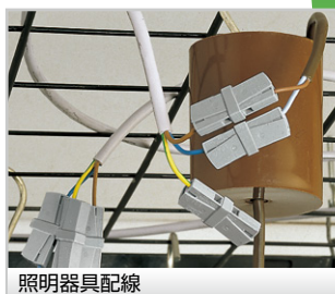
照明器具配線
